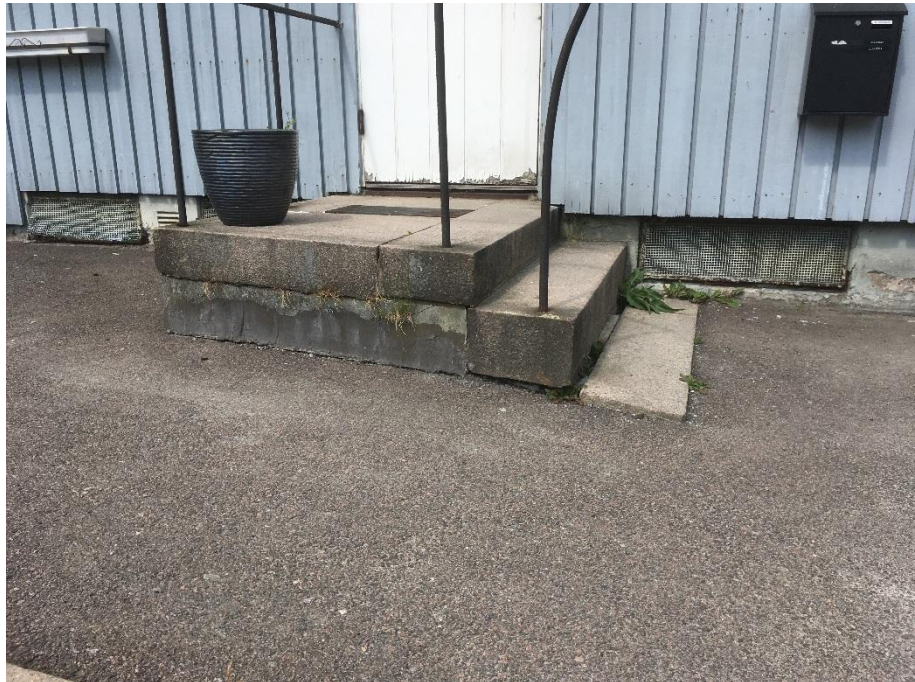
Bild 7. Tecken på pågående sättningar vid trappan.
