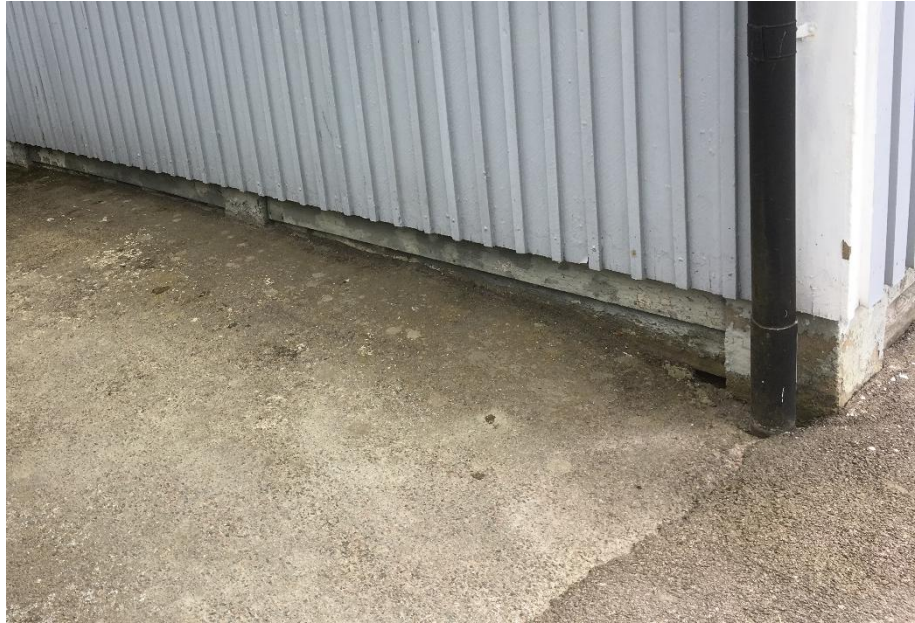
Bild 6. Tecken på pågående sättningar längs husets grund.
